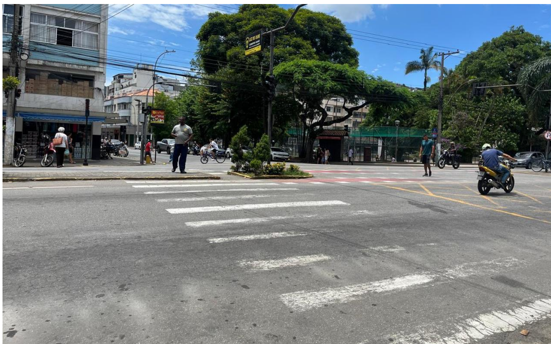
Figura 32: Sinalização horizontal desgastada em faixa de pedestre
