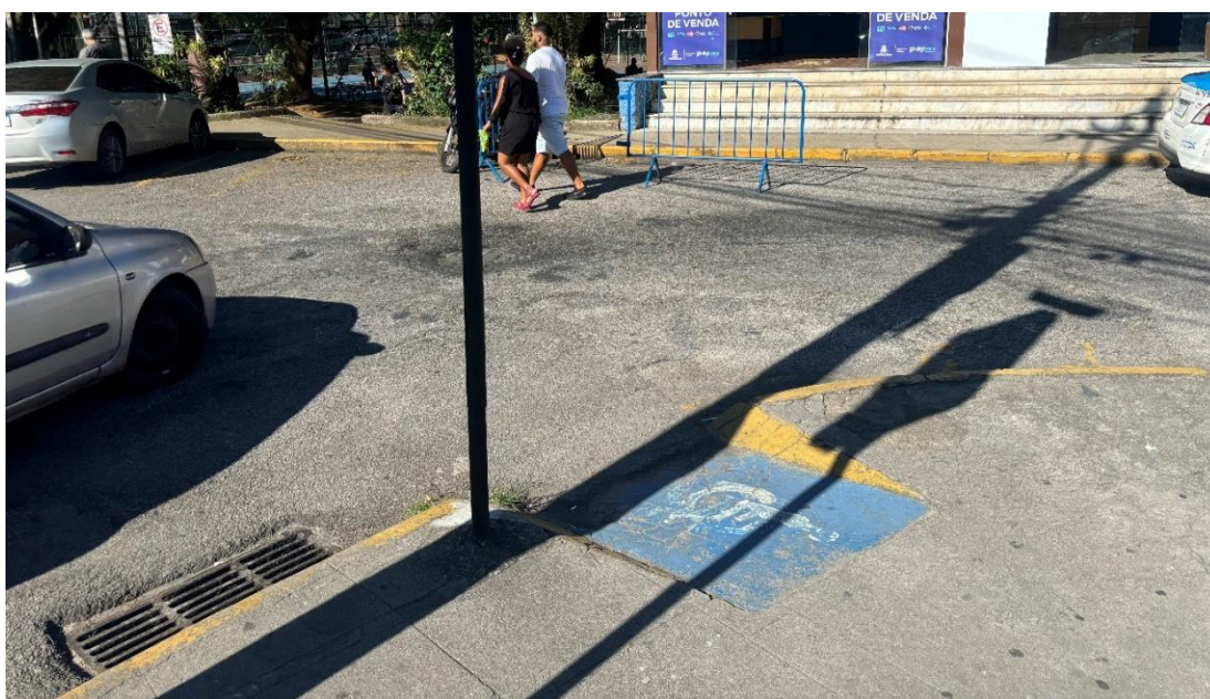
Figura 37: Rampa de acessibilidade necessitando de melhoria
