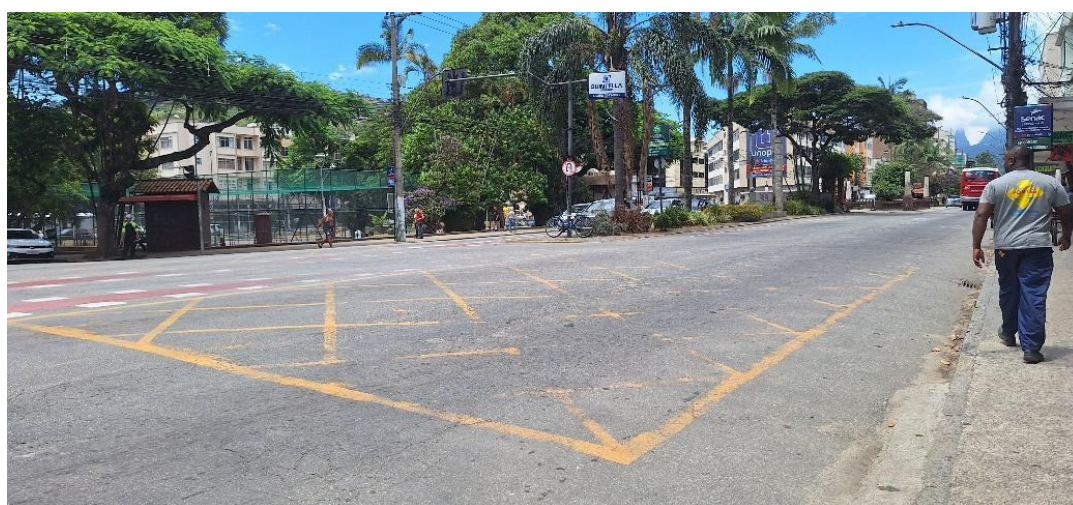
Figura 31: Sinalização horizontal desgastada em intercessão
