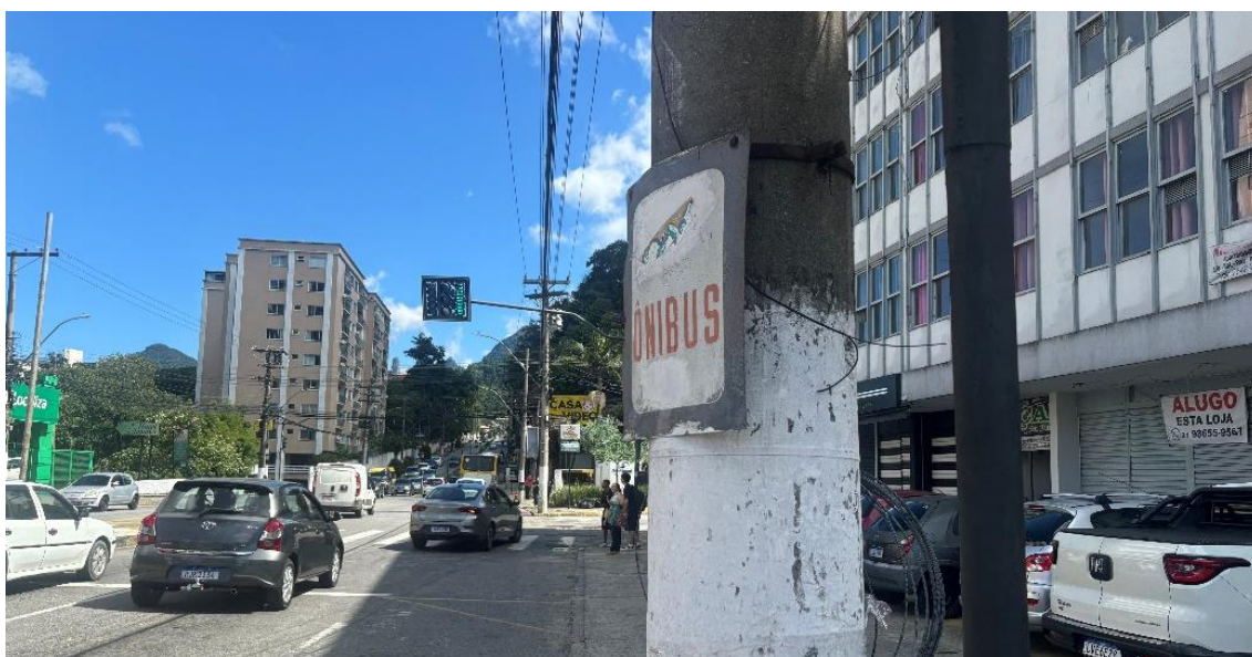
Figura 33: Sinalização vertical de ponto de embarque e desembarque desgastada
