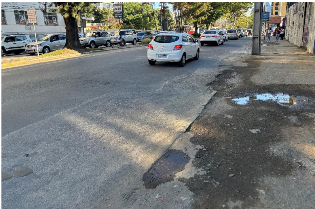
Figura 36: Calçada em más condições
