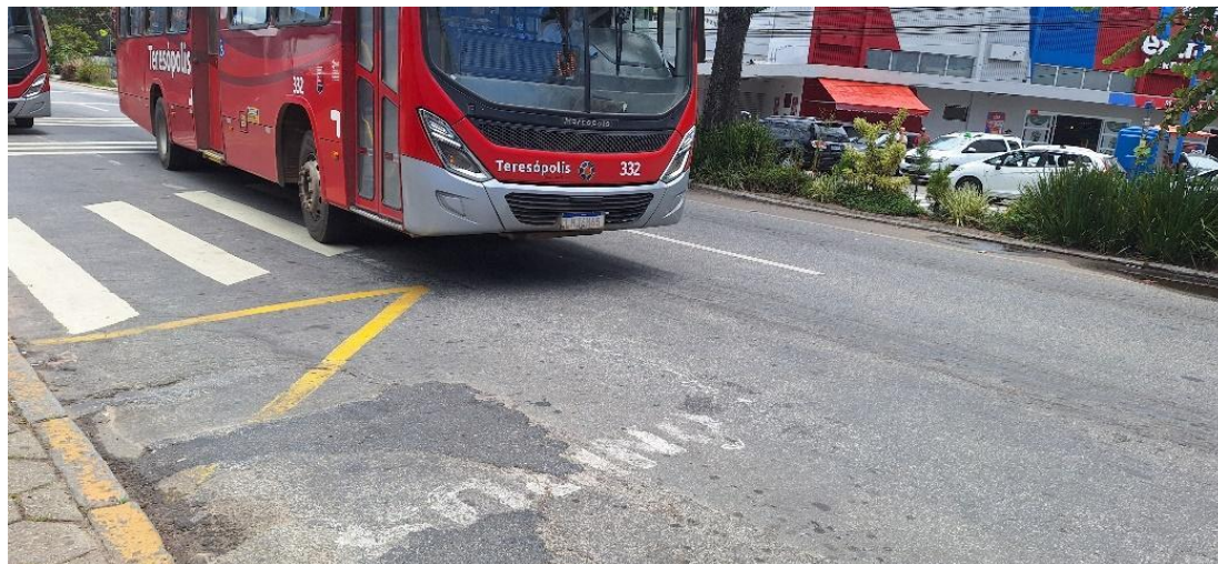
Figura 30: Sinalização horizontal desgastada em ponto de parada
