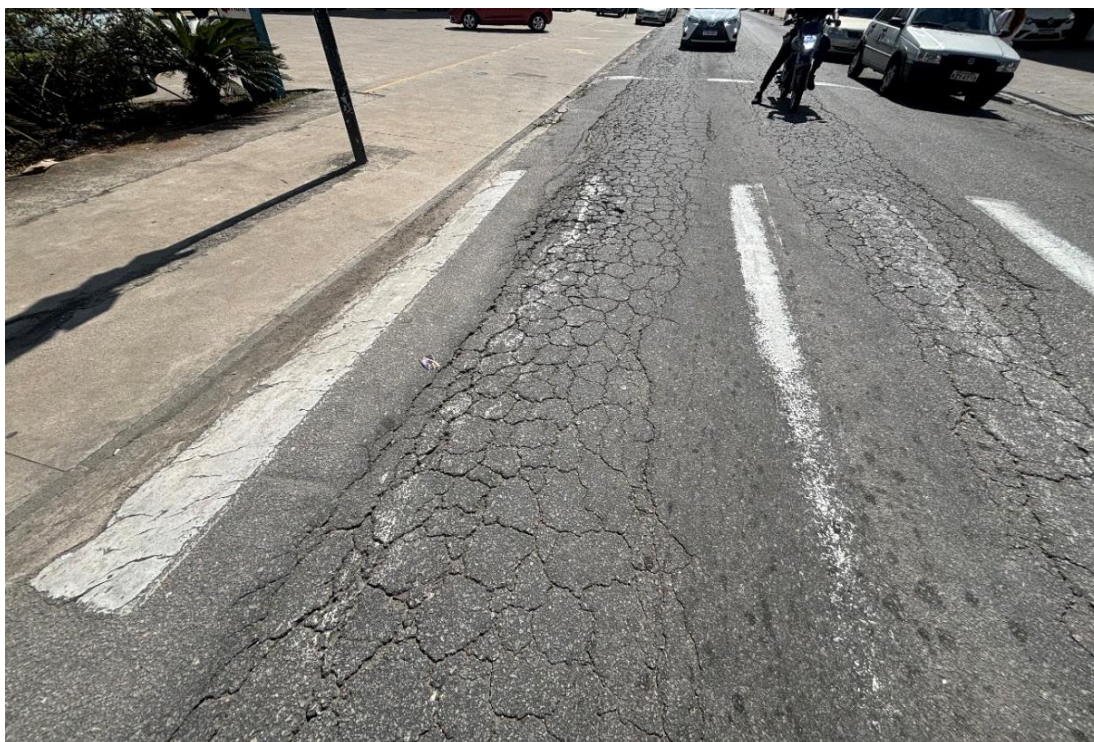
Figura 39: Pavimento asfáltico em más condições
