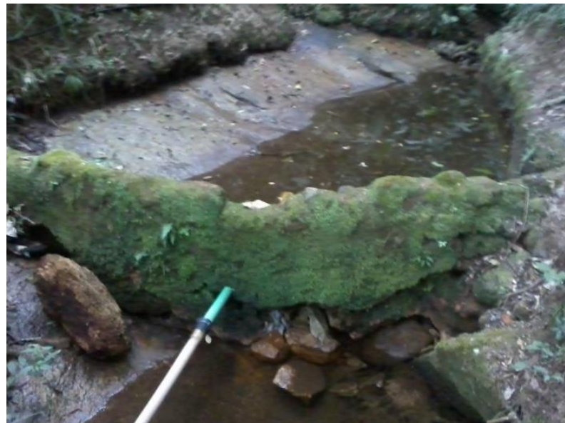
Figura 15 – Captação Fazenda Suspiro.
